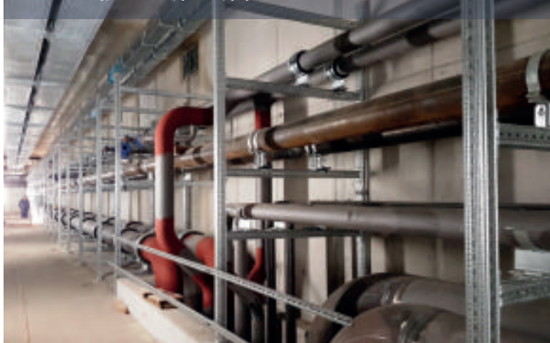
Widok na ciąg z instalacją zasilającą
